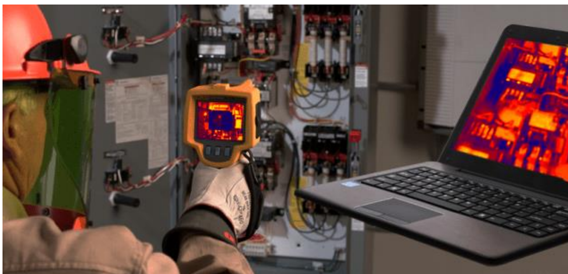
Рисунок 20. Пример проведения тепловизионного контроля электрошкафа
