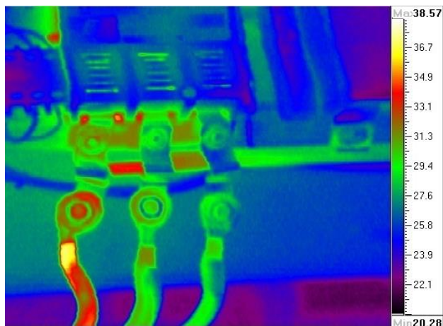
Рисунок 21. Пример термограммы контактных соединений с температурной шкалой
